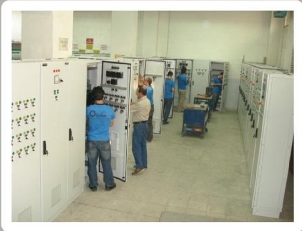
TEST & CONTROL CENTER TEST & KONTROL MERKEZİ
