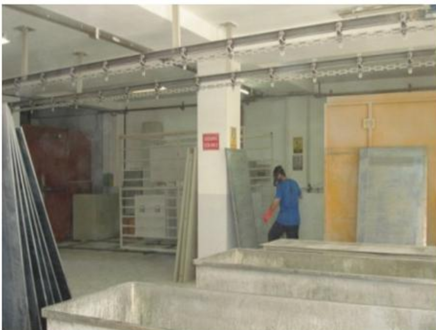
PAINTING SHOP ELEKTROSTATİK TOZ BOYA BÖLÜMÜ
